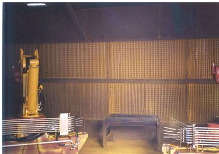
실제 설치현장의 예 (2)
